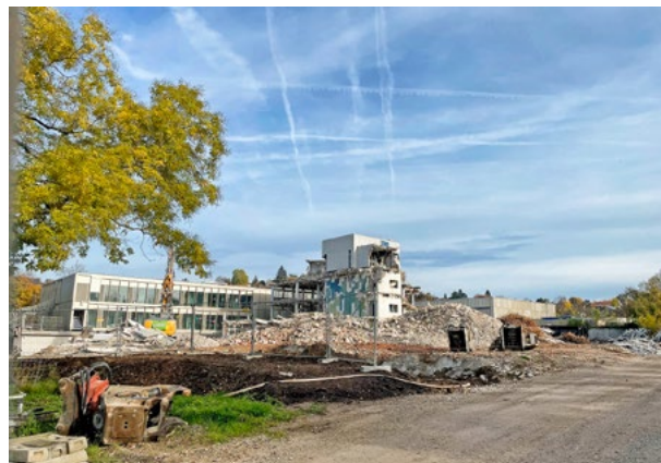
Abbruch des Bestandsgebäudes. Im Hintergrund ist der Nordflügel des Neubaus zu sehen
